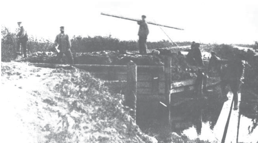
Разрушенная дамба на Приморской железной дороге
